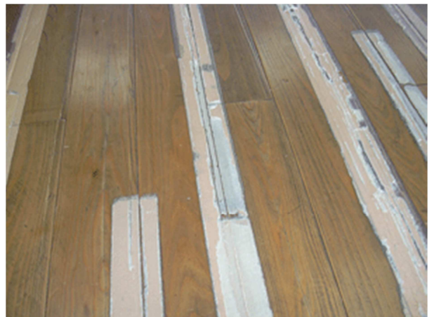
② 最早、補修も効かないほど 床板が傷んでいます。
